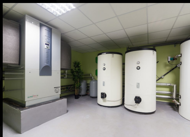
Vnitřní instalace vzduch/voda - LW 251
